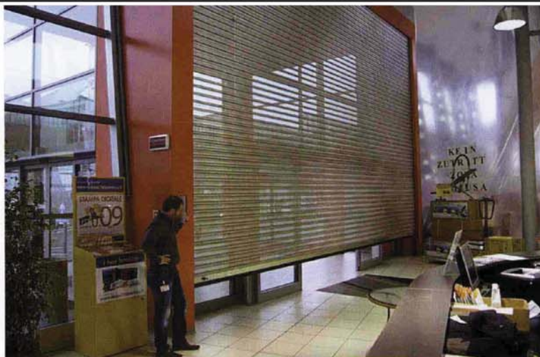
La serranda ad avvolgimento Hörmann Hr 120 in versione Aero è stata scelta per la chiusura notturna dell'ingresso principale.
