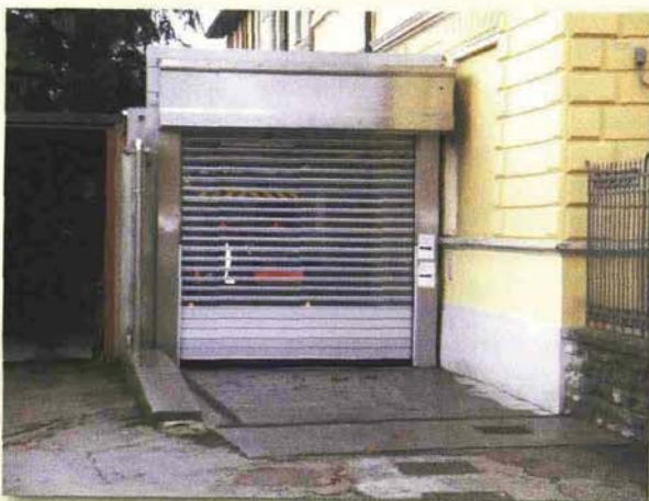
Sopra, la nuova serranda HSR installata presso l'ospedale di San Piero in Bagno.
